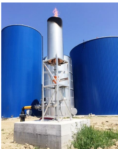
Fig. 4 -Flacăra biogaz F800
