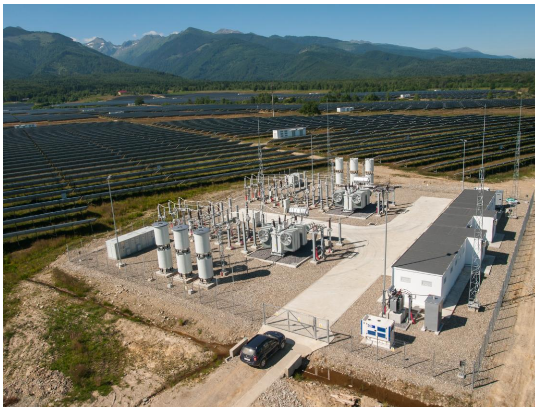
Imaginea 5 – Stație de transformare 20/110 kV
