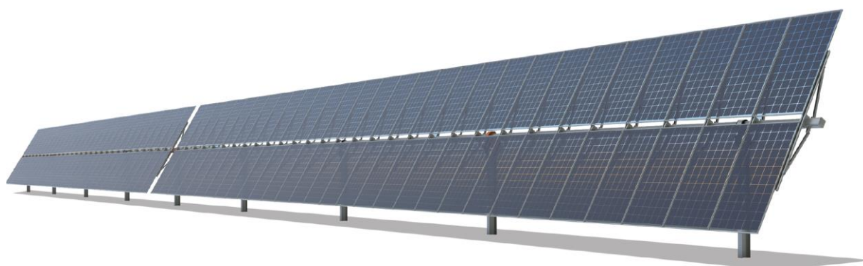
Imaginea 2 – Panouri fotovoltaice, structura tip tracker, 1 axa
