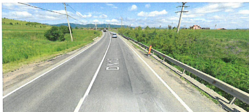
Foto – sectorul afectat km 20+515 – km 20+547 - tasari, crapaturi la nivelul părții carosabile pe banda dreaptă (preluare google earth mai 2021)
